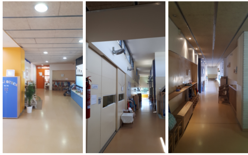
Imatge 28: Enllumenat passadissos Can Llong: Downlights, focus i halògens
