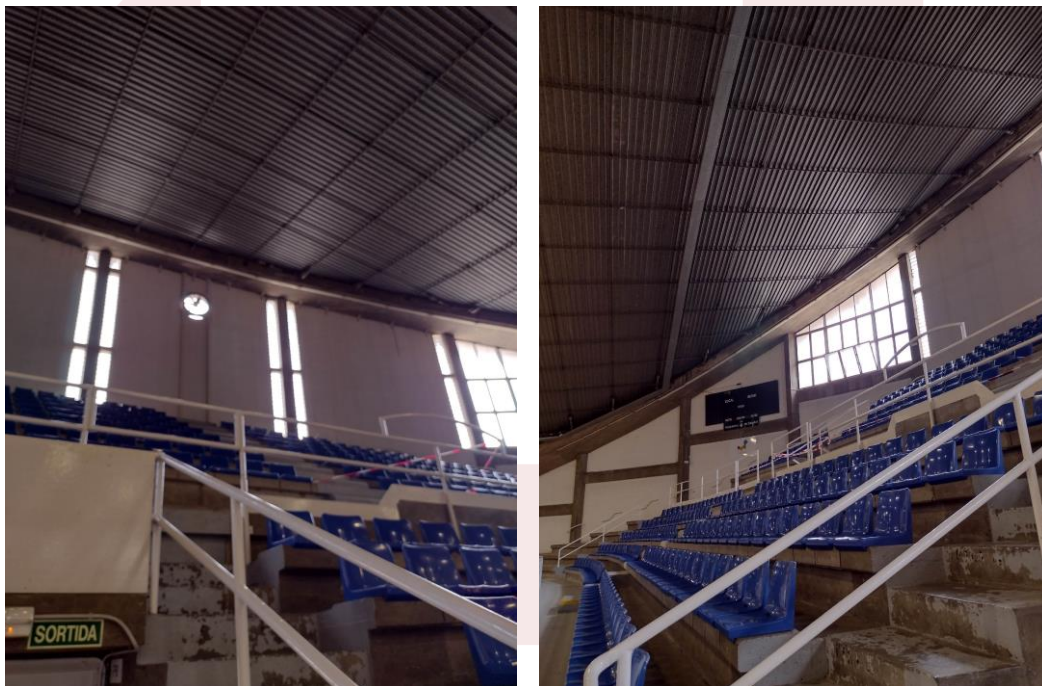
Luminarias de Planta primera, Graderío.
