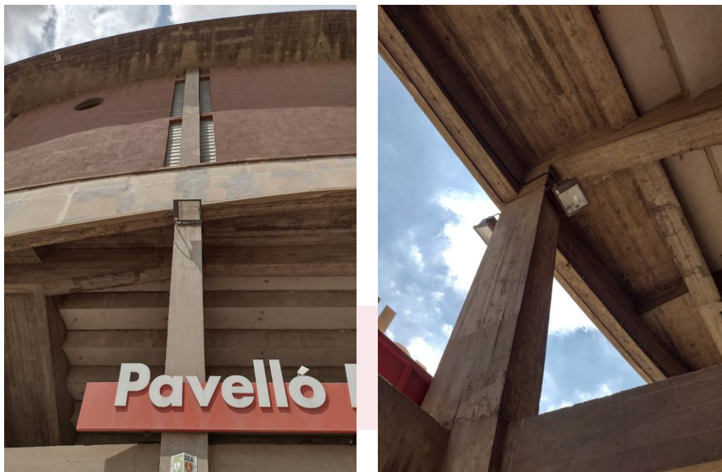
Luminarias de Planta baja exteriores.
