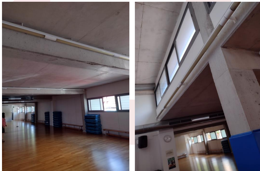
Luminarias de Planta Baja, Gimnasio
