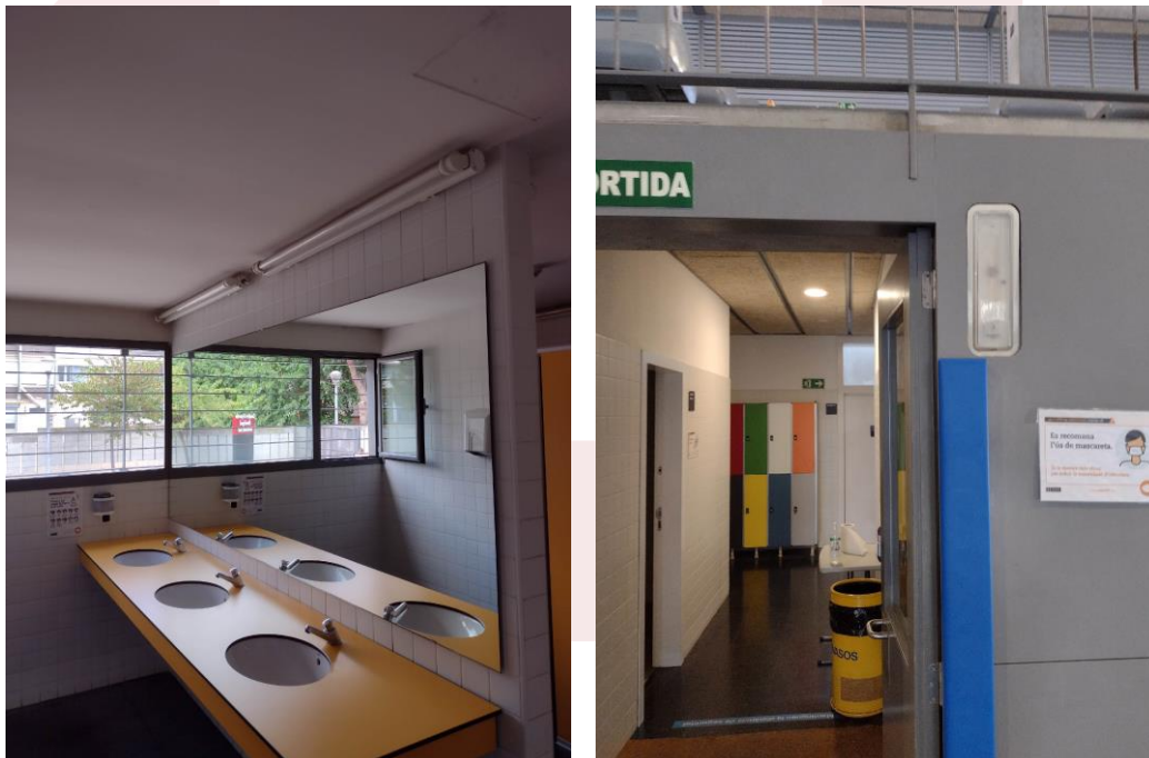
Luminarias de Planta Baja, Aseos y Acceso vestuaris.
