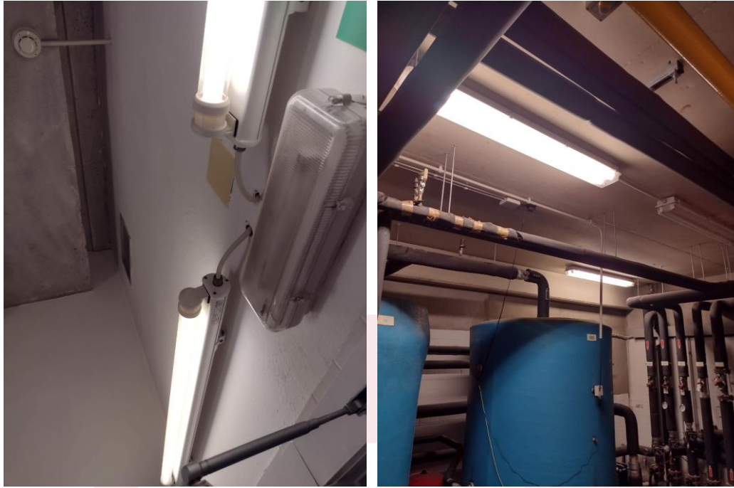
Luminarias Planta Baja, Vestuaris y Sala calderas.
