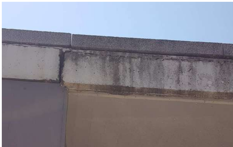
(6) Junes sense segellar entre el forjat i la capa de morter per col·locar la peça de coronació de l'ampit de coberta
