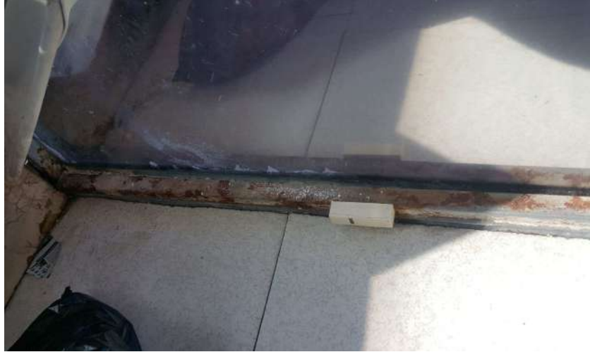
Oxidació de la fusteria de ferro interior
