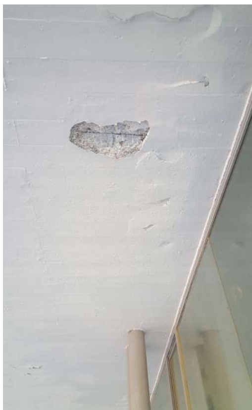
Desprement part del forjat de formigó
