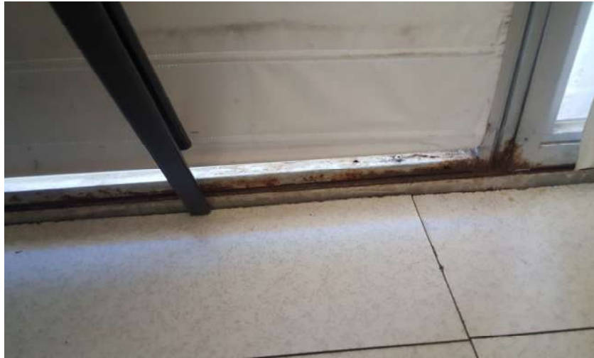
Oxidació de la fusteria de ferro interior
