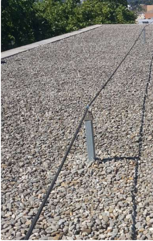
(2) Anclatges suports línia de vida ancorats directament sobre la tela asfàtica.
