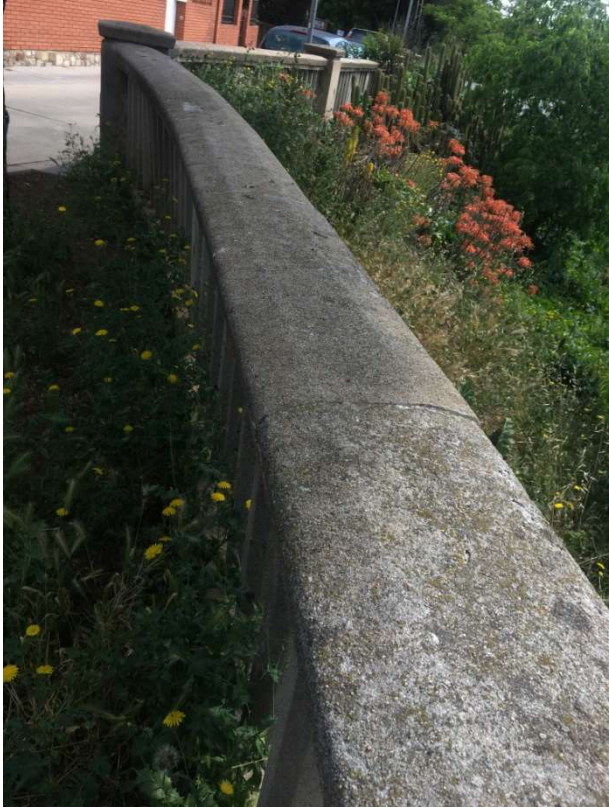
6.1 Enfonsament vorera, fonament col.lapsat. Tram nou i tram banc 8 m. zona arbres, tram bolcat, 12,50 m. Manquen balustres, peces mogudes, 5,8 m. bolcat lleugerament, peces, 5,6 m irregularitats diverses, 5,6 m.
