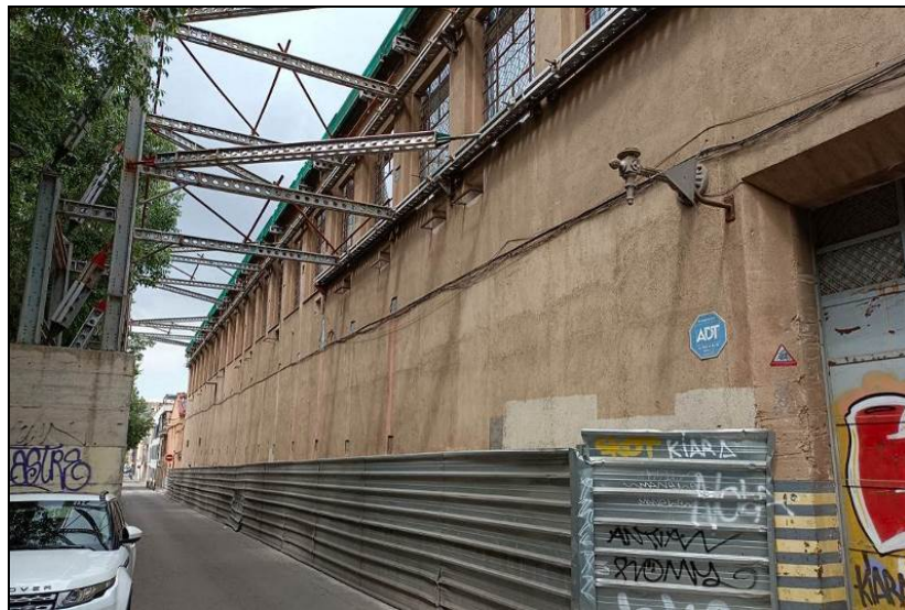
Fotografia dels estabilitzadors existents al C/Alemanya de Sabadell.
