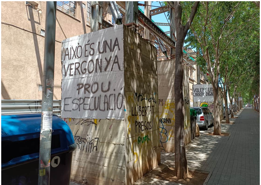
6082.A.1 Projecte i bàsic i d'execució de la retirada dels actuals estabilitzadors de les façanes protegides del Vapor de Ca l'Escardat i execució dels nous estabilitzadors de façana per l'interior de l'edifici. C/Alemanya, 60. Sabadell.
