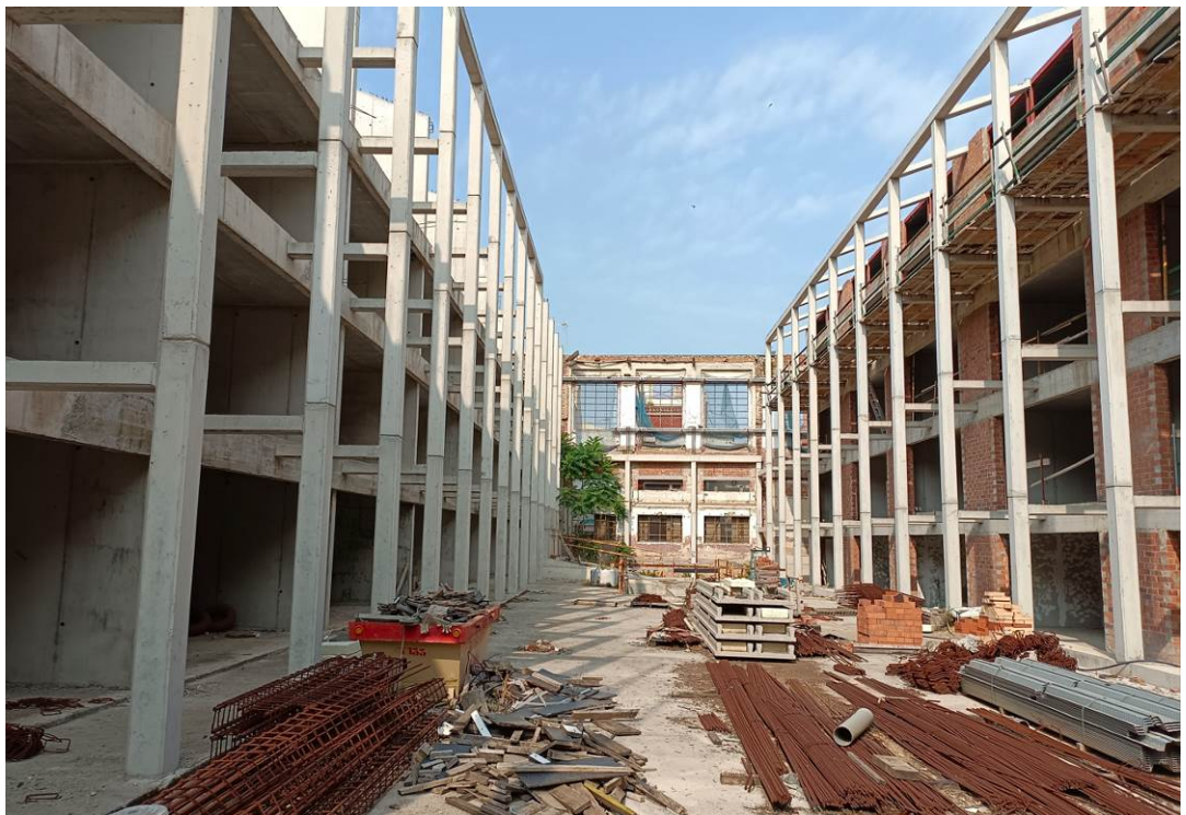
6082.A.1 Projecte i bàsic i d'execució de la retirada dels actuals estabilitzadors de les façanes protegides del Vapor de Ca l'Escardat i execució dels nous estabilitzadors de façana per l'interior de l'edifici. C/Alemanya, 60. Sabadell.
