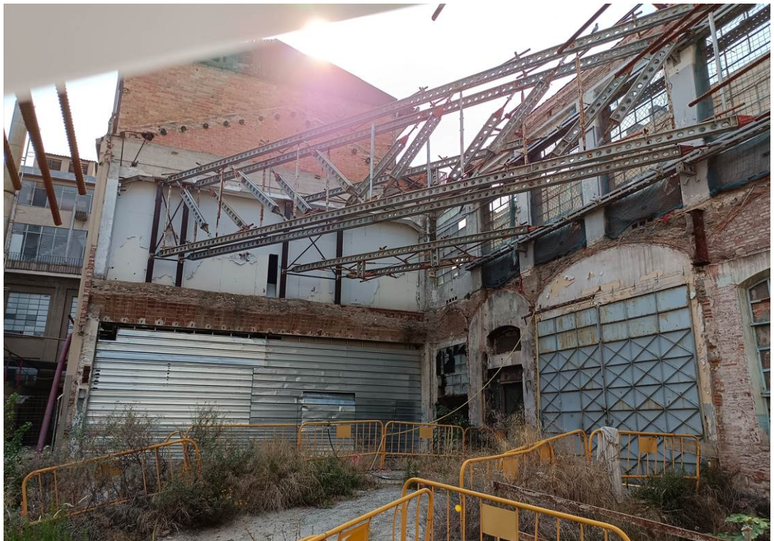
6082.A.1 Projecte i bàsic i d'execució de la retirada dels actuals estabilitzadors de les façanes protegides del Vapor de Ca l'Escardat i execució dels nous estabilitzadors de façana per l'interior de l'edifici. C/Alemanya, 60. Sabadell.
