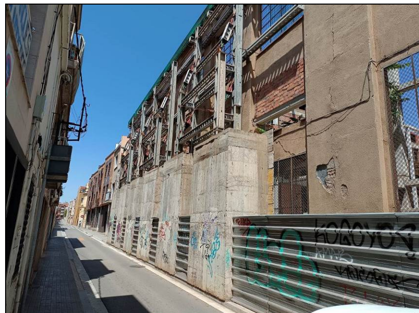
Fotografia dels estabilitzadors existents al C/Ferran Casablanças de Sabadell.
