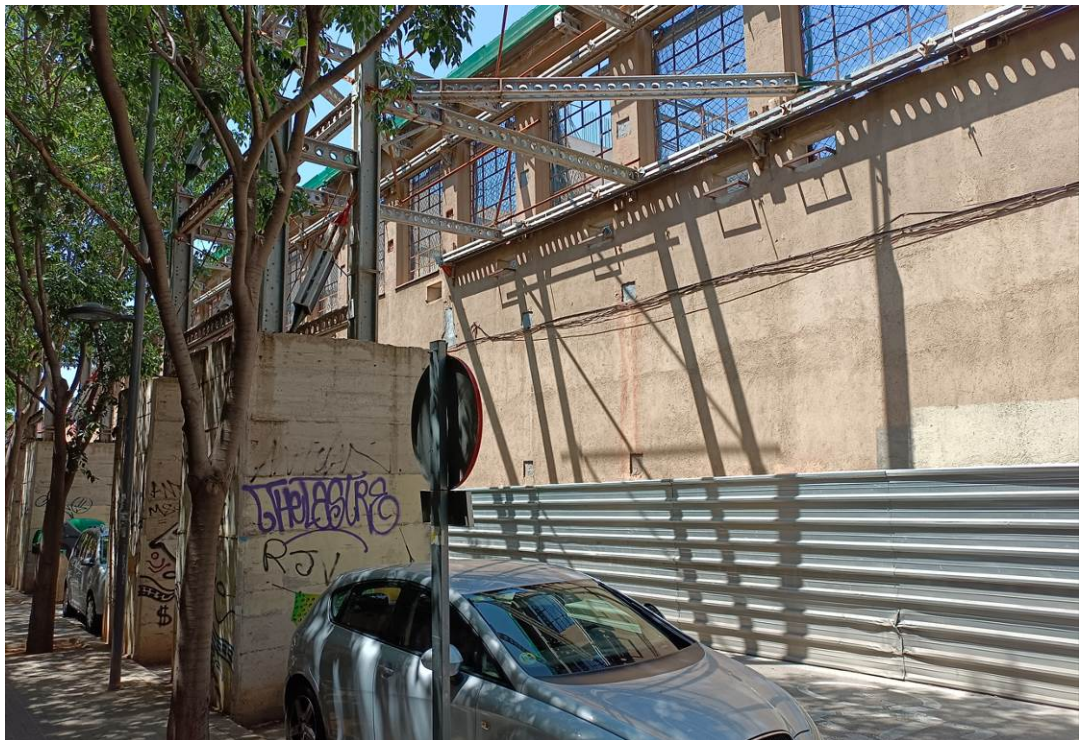
6082.A.1 Projecte i bàsic i d'execució de la retirada dels actuals estabilitzadors de les façanes protegides del Vapor de Ca l'Escardat i execució dels nous estabilitzadors de façana per l'interior de l'edifici. C/Alemanya, 60. Sabadell.
