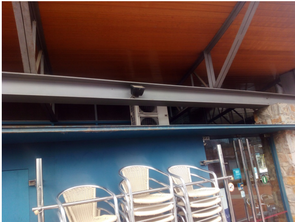
Màquines exteriors d'aire condicionat
