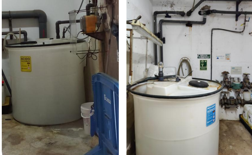
Dipòsits d'àcid sulfúric i hipoclorit sòdic
