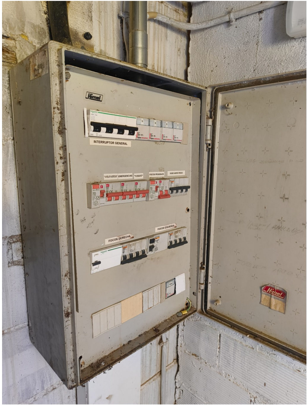
QUADRE ELÈCTRIC IL·LUMINACIÓ
