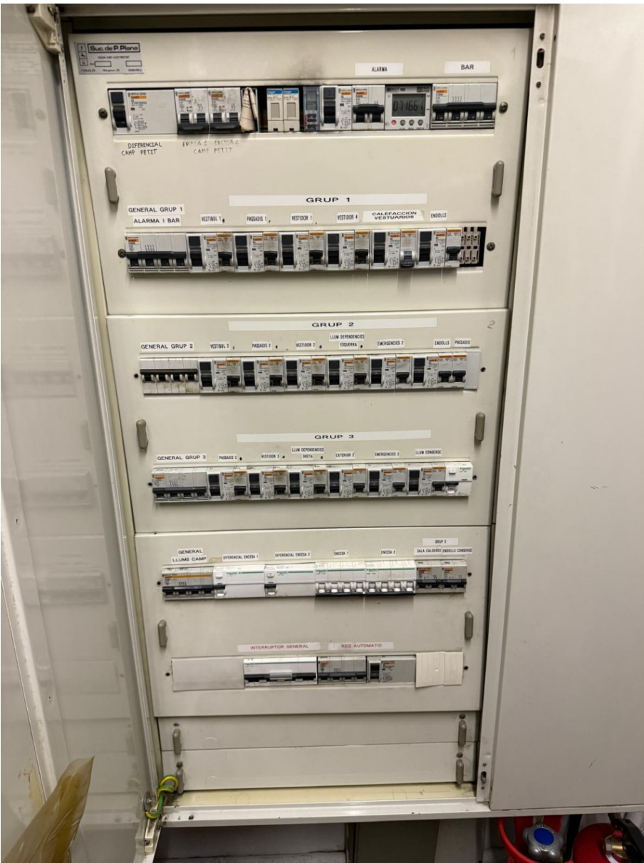
QUADRE ELÈCTRIC GENERAL DE L'EQUIPAMENT
