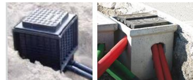
Imatge 2. Exemple de pericons (polipropilè reforçat i de formigó)
