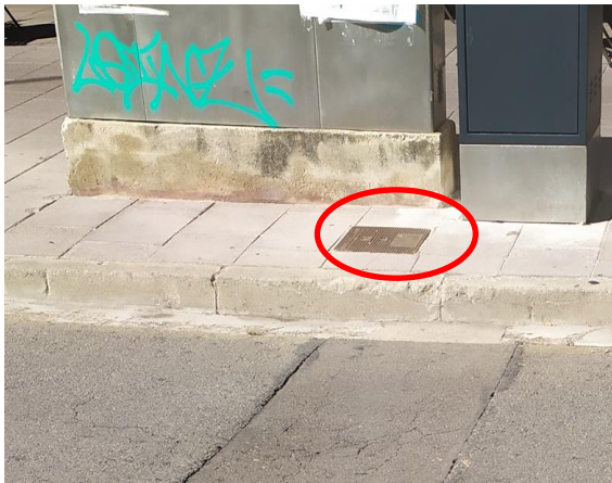
Figura 7. Tapa de registre (sense identificar) junt a l'armari d'instal·lacions del C/ Latorre.
