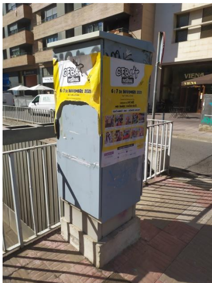
Figura 5. Armari d'instal·lacions (servei no identificat) situat a vorera de la franja lateral del pont (costat Carrer Latorre).
