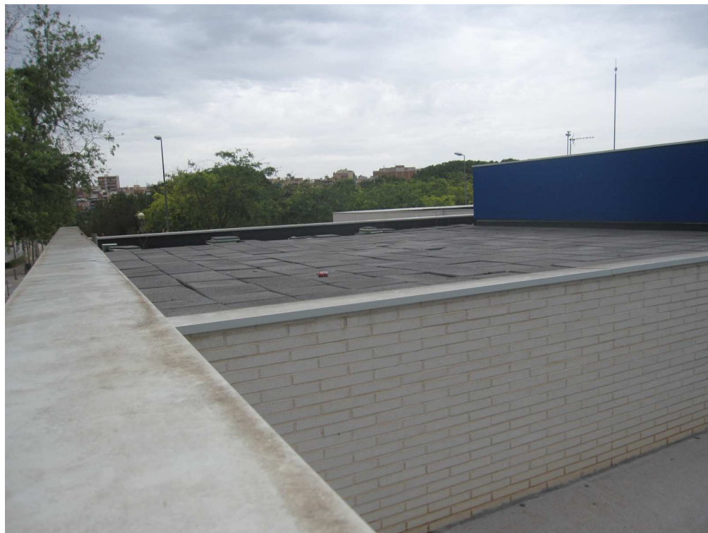
Tram de coberta on s'ubicarà un dels equips de refrigeració evaporatiu, sobre aules 7 i 8.
