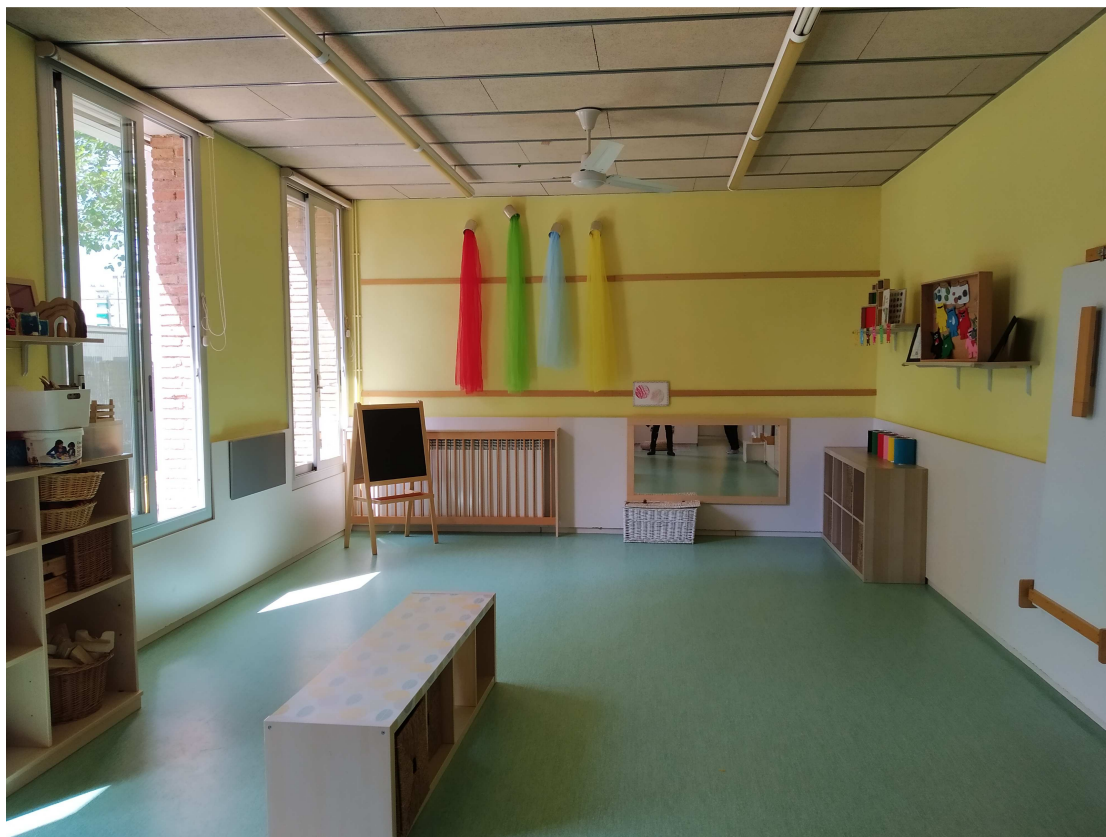
Aula 7, ubicació unitats interiors aire condicionat
