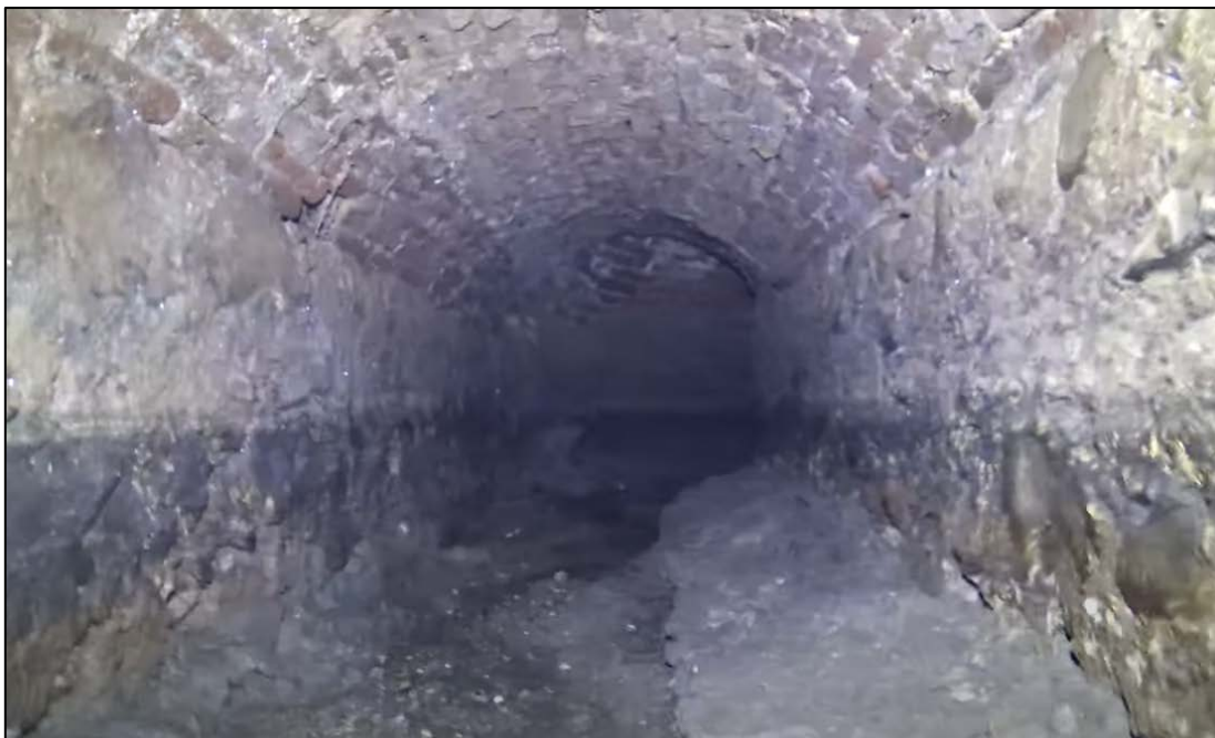
Figura 3: Entrada nord a la mina (a dalt esquerra); tram contemporani amb canonada de formigó DN 1000 (a dalt a la dreta); secció en mina antiga (a baix – font: vídeo fet per els hortolans)
