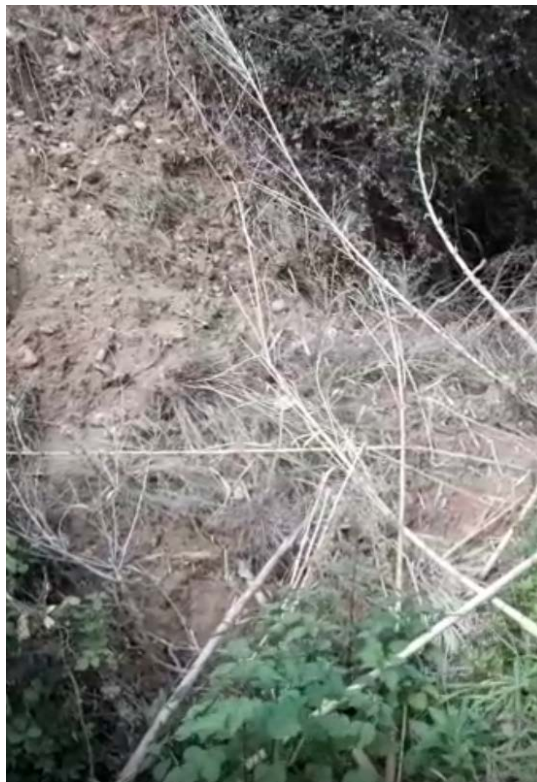
Figura 8: Esllavissada del talús a l'entrada de la mina/galeria
