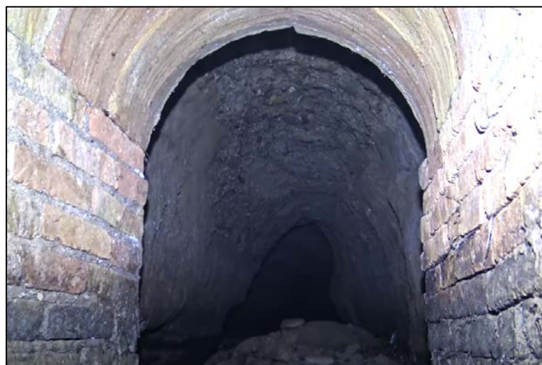
Figura 6: Esfondrament produït a la galeria en mina antiga (Font: vídeo dels hortolans)
