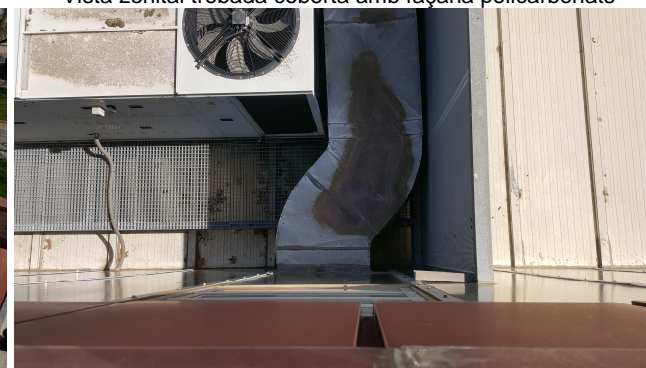
Vista instal·lacions climatització
