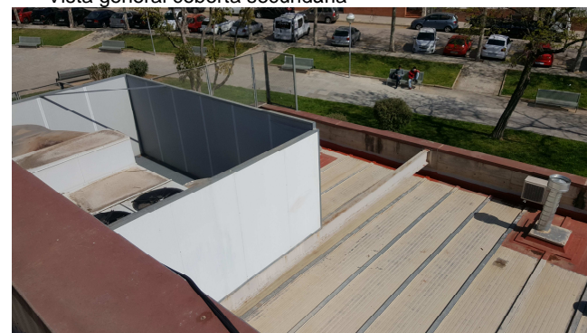
Vista zona instal·lacions climatització coberta secundària
