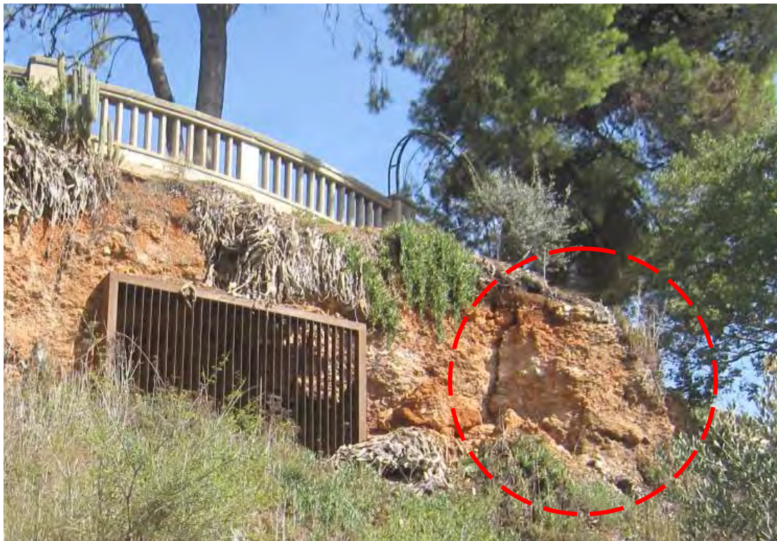
Coves A i B. Cova B, zona amb perill de despeniment
