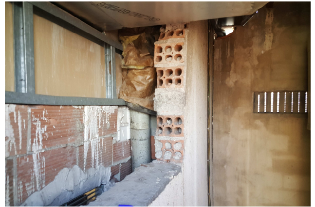
7. Retorn aire condicionat actual
