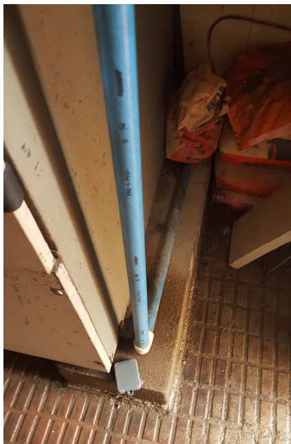
10. Bancada recolzament màquina actual
