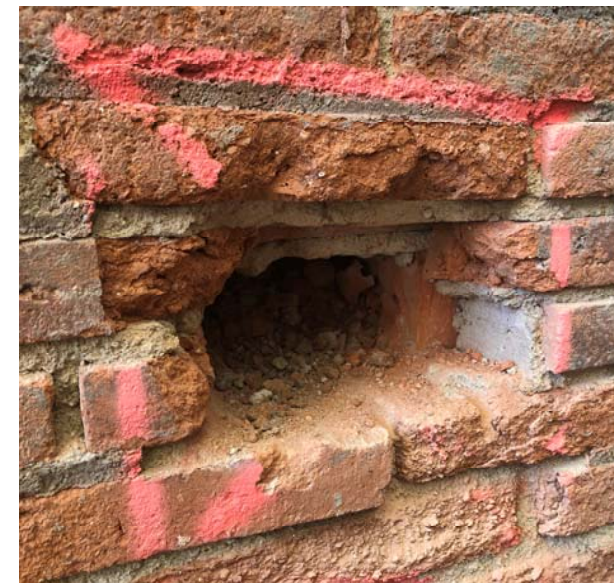
Imatges A7 – Mur de contenció moll de descàrrega pati 2-3
