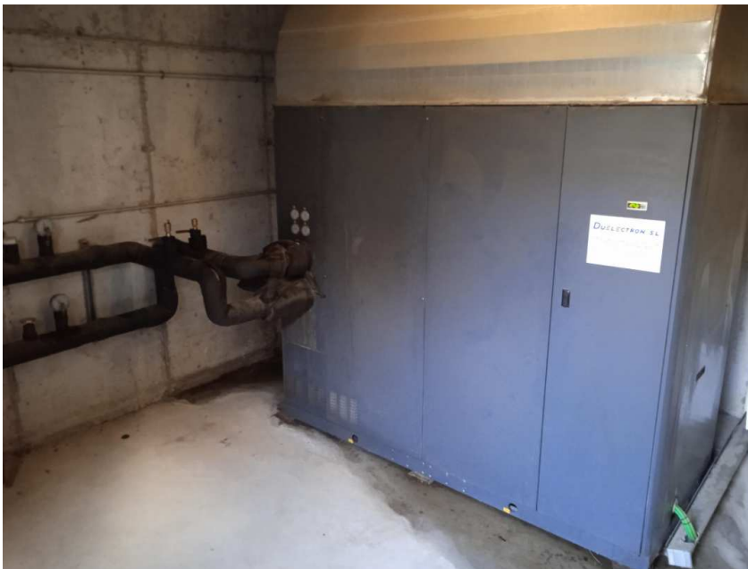
Planta refrigeradora actual. Model GALLETTI LCC105HS
