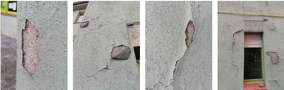
PATOLOGIES AL REVESTIMENT EXTERIOR
