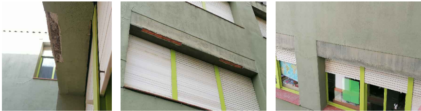
PATOLOGIES A LES CAIXES DE PERSIANES
