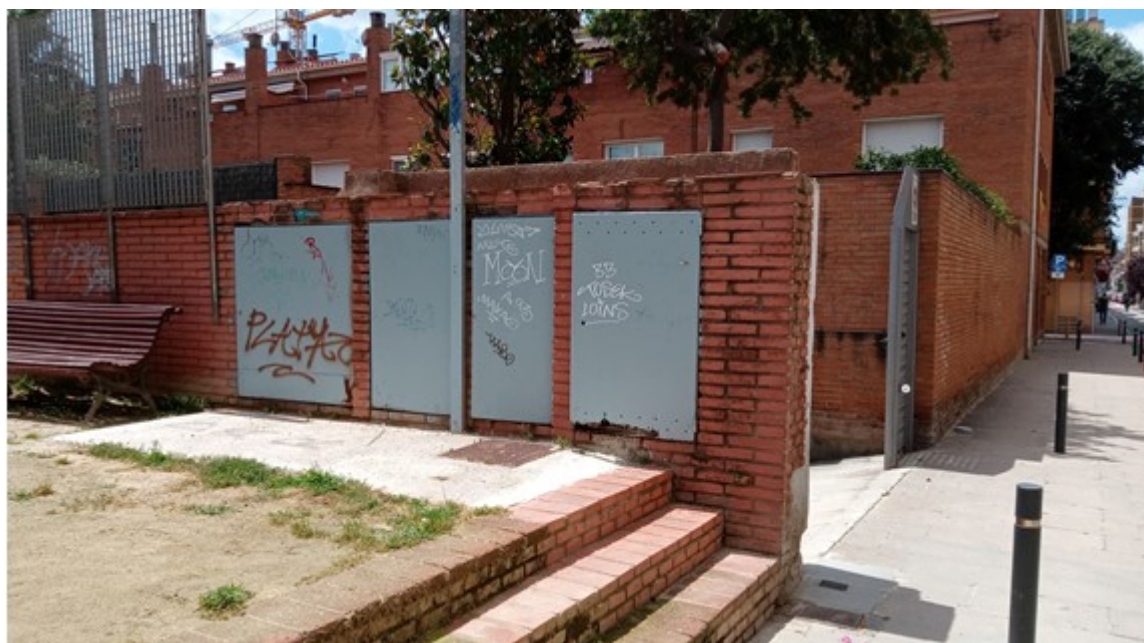
ARMARIS INSTAL·LACIONS ENLLUMENAT, ESCOMESA ELECTRICITAT I ESCOMESA AIGUA EXISTENTS A LA PARET LATERAL OEST DES DEL C. ESCOLA PIA
