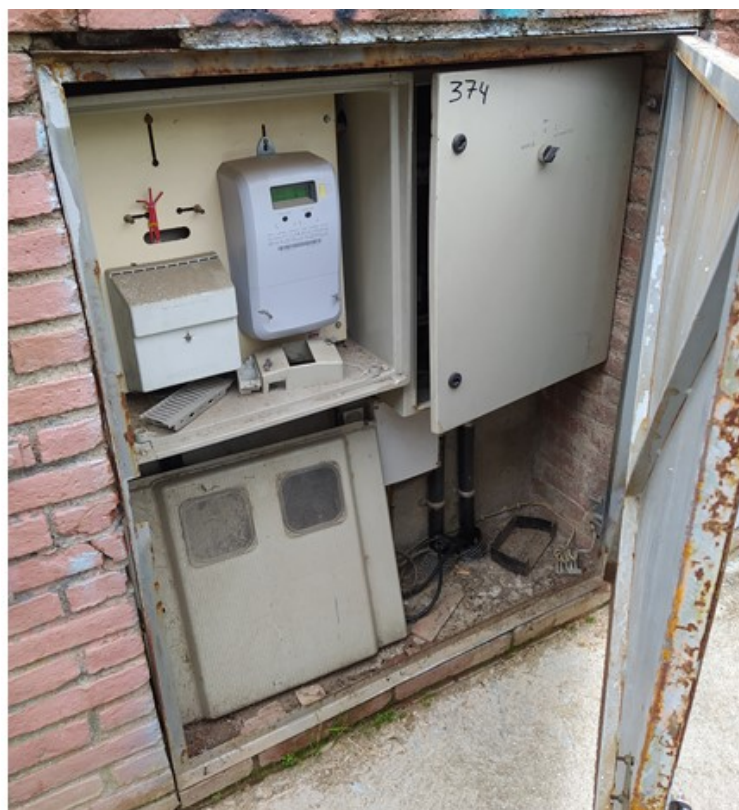
ARMARI INSTAL·LACIÓ ELECTRICITAT I COMPTADOR EXISTENT
