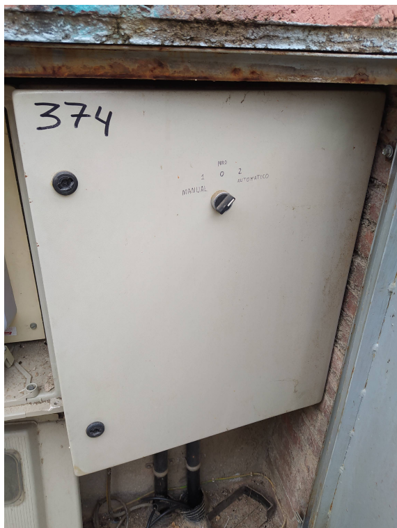
Quadre elèctric enllumenat públic existent
