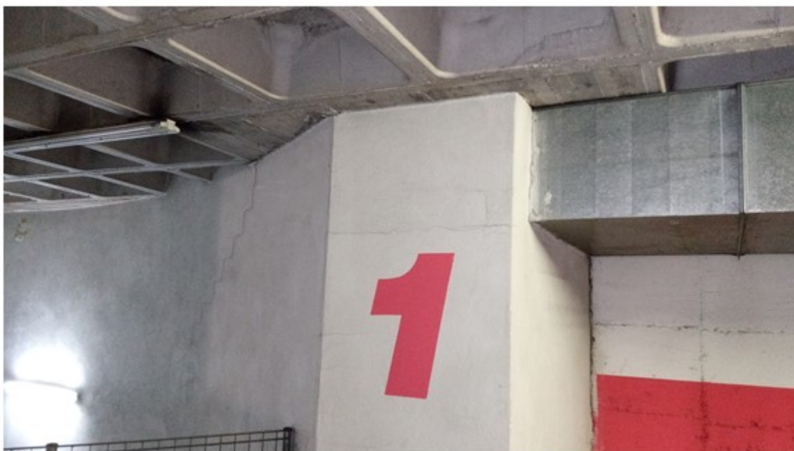
SORTIDA CONDUCTE VENTILACIÓ SOTERRANI -1 COSTAT EST C. ESCOLA PIA
