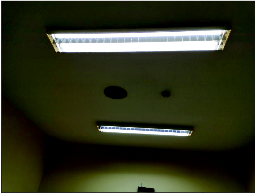
Il·luminació oficina entresol
