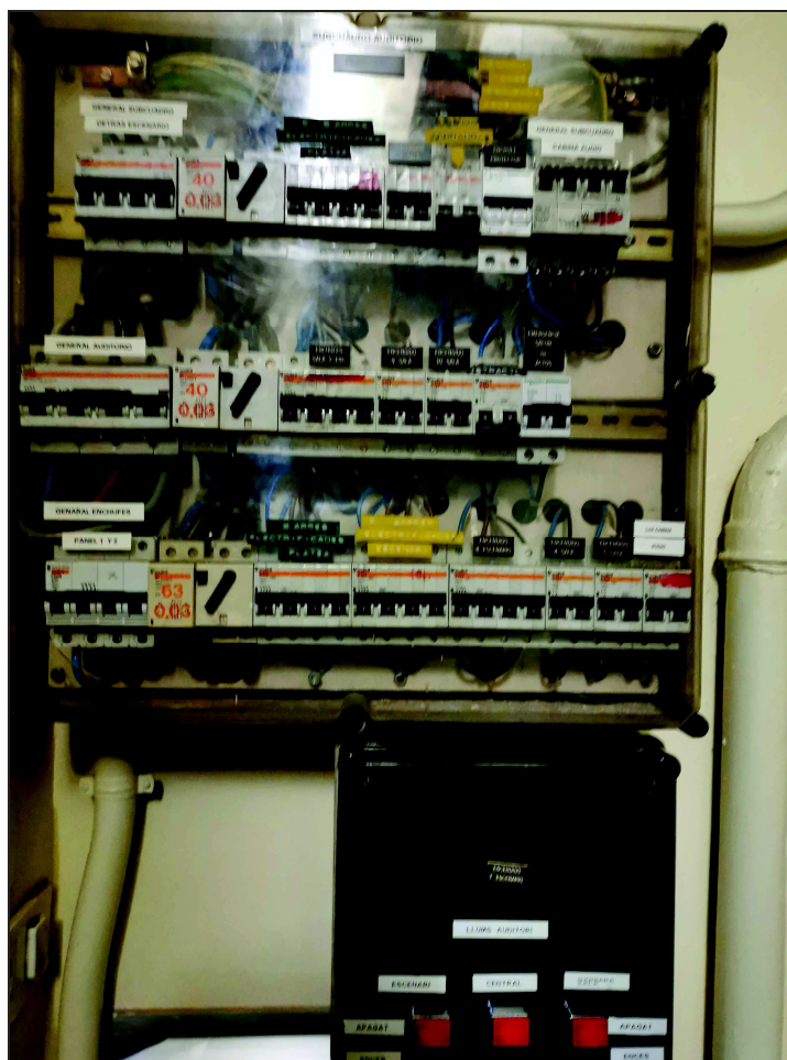
Subquadre elèctric auditori
