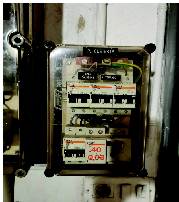
Subquadre elèctric planta coberta
