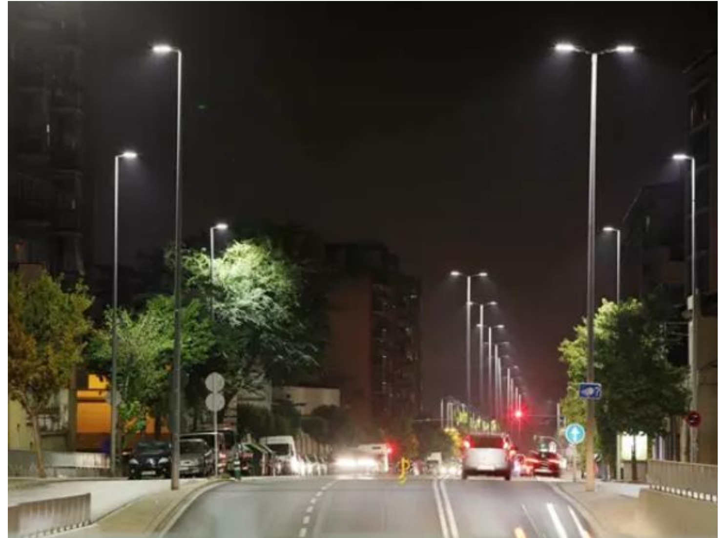
PROJECTE DE SUBSTITUCIÓ DE FANALS A SABADELL
