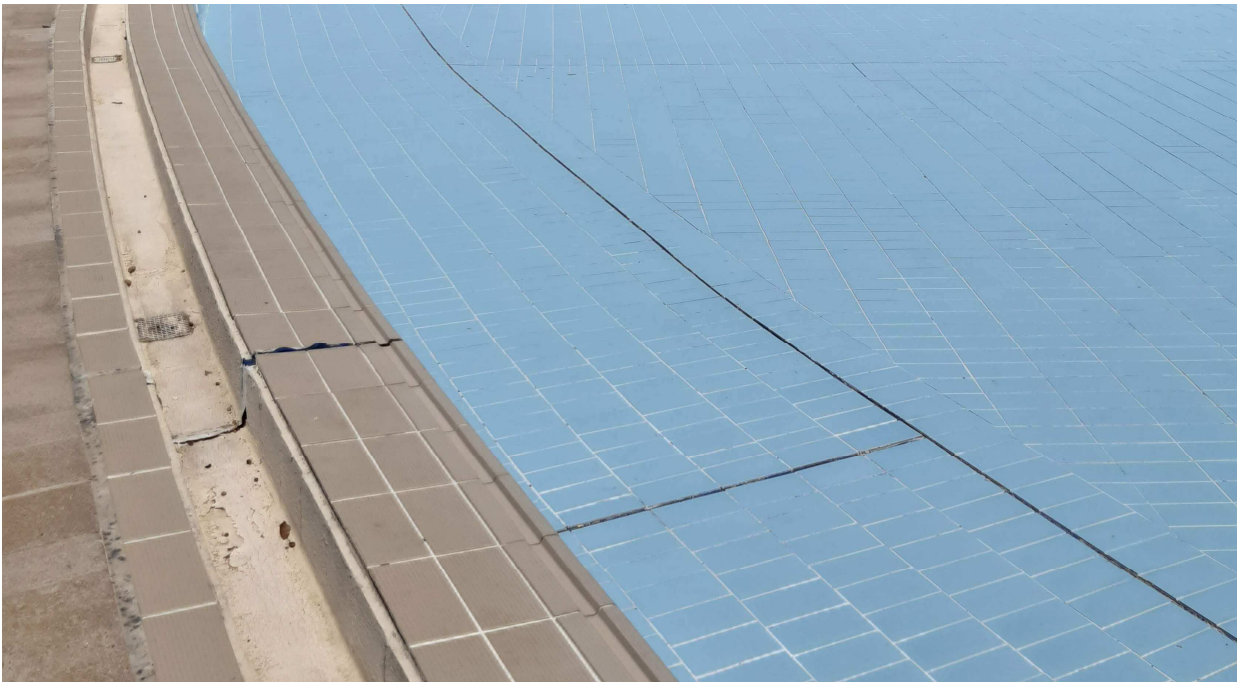
Canal perimetral desbordant
