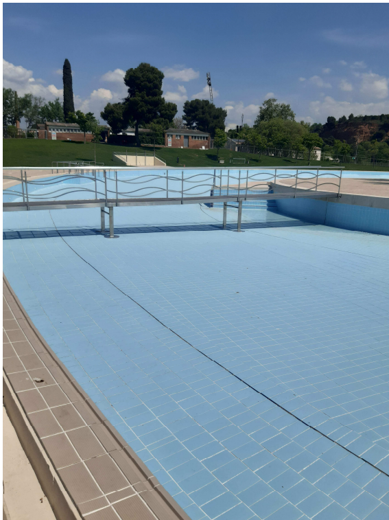
Juntes de dilatació en paviment. Peces de paviment senceres
