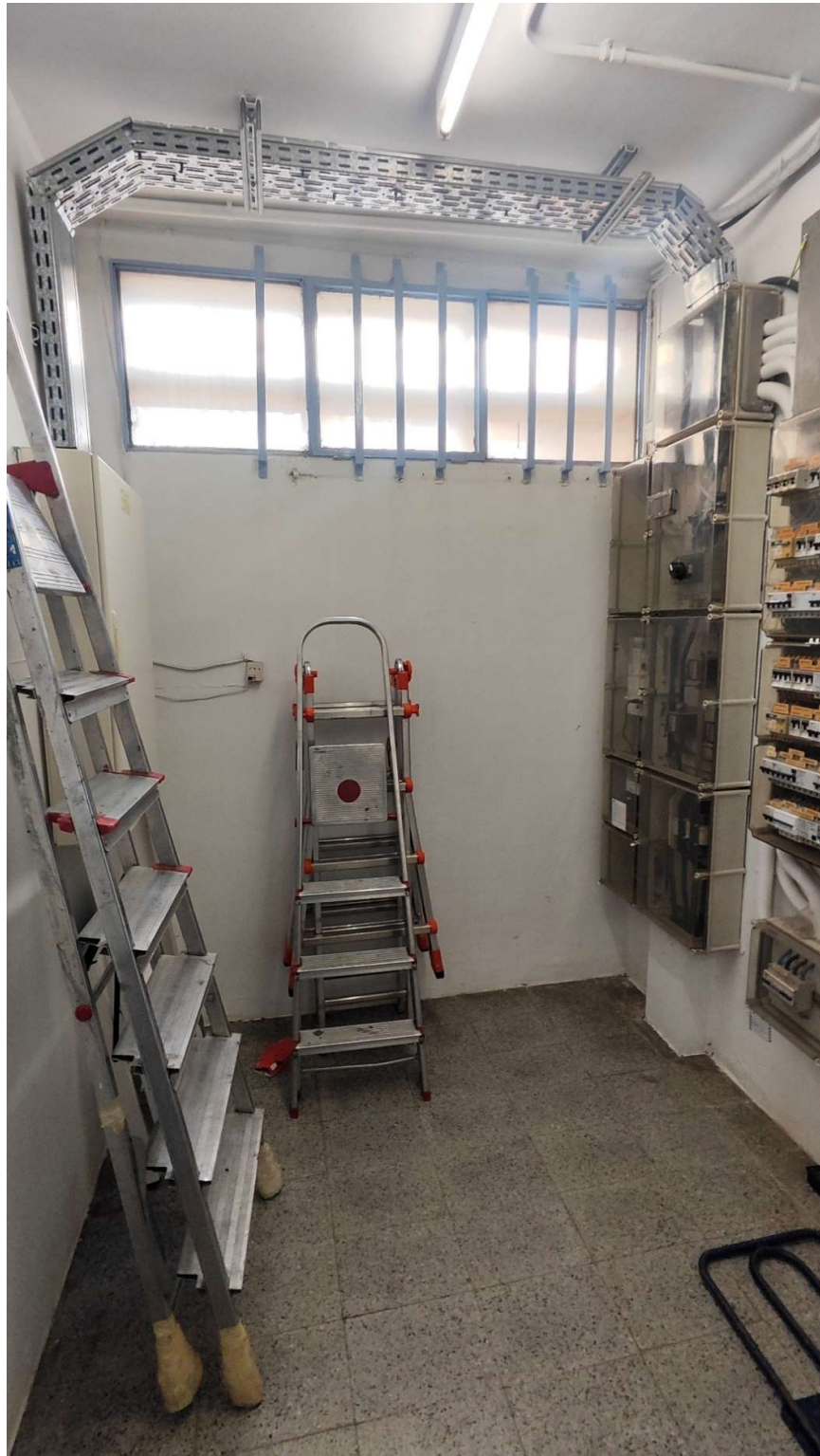
Fig. 13 Vista de la sala d'equips on s'ubicarà el quadre de proteccions FV-CC. Com es mostra als plànols la paret del fons d'aquesta sala es mourà a fi d'encabir l'armari on s'ubicaran les TMFs el qual serà accessible des del carrer per part de la companyia elèctrica.
